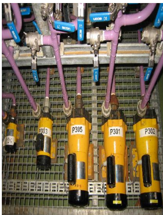
Afbeelding 3 Pompenstraat met centrifugaalpomp van de 300 unit
